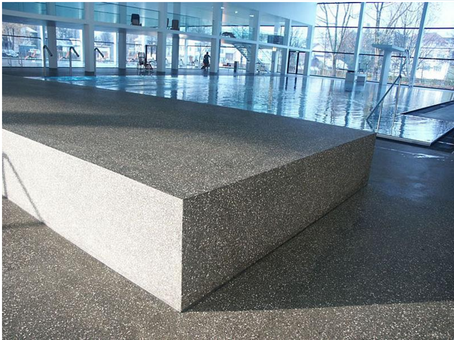
Rys. 19. Posadzka wykonana z MA
